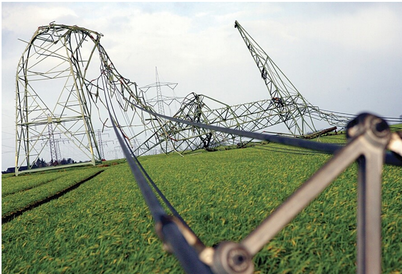
Fot. 1. Zdjęcie linii napowietrznych uszkodzonych podczas wichury.
