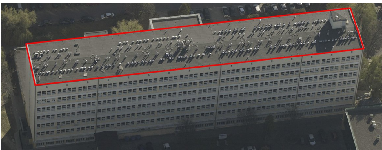
Rys. 3. Przykład dachu nie nadającego się do montażu paneli fotowoltaicznych ze względu na zbyt dużą liczbę instalacji – Lublin, ulica Akademicka 11.
